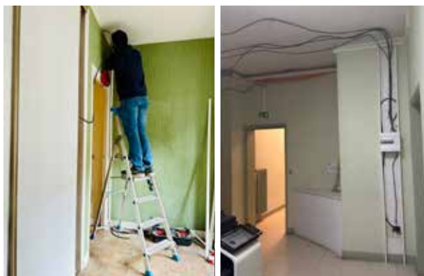
Poursuite de la réhabilitation du bâtiment de l'hôtel de ville : mise aux normes électriques
